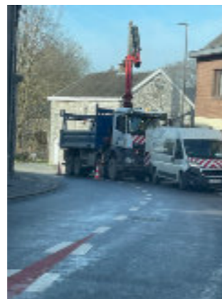
Modification de l'éclairage dans le bas de la rue Village et suppression des anciens poteaux de béton
