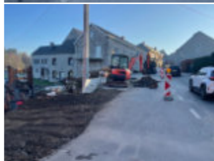
Début des travaux d'égouttage dans le début de la rue Falise et pose d'une nouvelle canalisation d'eau
