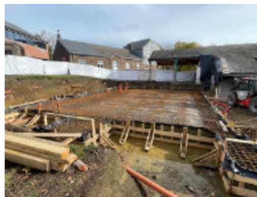
Après le terrassement, début de la phase de construction à l'école de St-Hadelin
